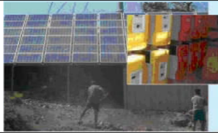
Şekil 5.6 - Girasolar Ltd. tarafından Fethiye-MUĞLA'da bir adaya inşa edilen Fotovoltaik-Rüzgar-Dizel generatör hibrit güç sistemi
