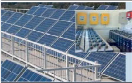
Şekil 5.5 - İzmir'de Ege Üniversitesi Güneş Enerjisi fotovoltaik güç sistemi (14 kWp ada ve 10 kWp şebekeye bağlı sistem)
