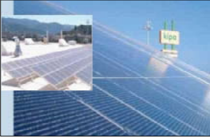
Şekil 5.7 – Marmaris'te Enisolar Ltd. tarafından inşa edilen 30 kWp şebekeye bağlı sistem
